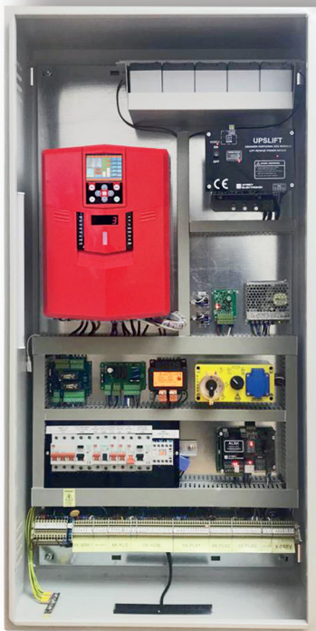
Schaltschrank Maschinenraum mit Frequenzumrichter MR VVVF Control Panel
